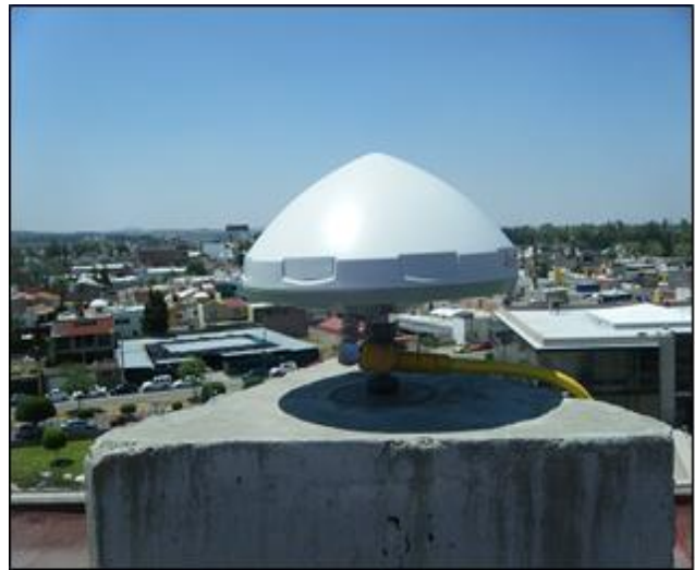
Antena GNSS colocada y orientada al norte geográfico
